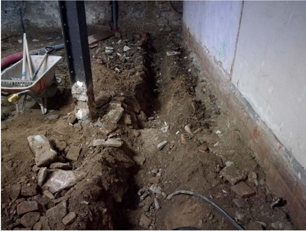
FOTOGRAFIA 11 → Imatge de la rasa d'evacuació d'aigües residuals a l'espai, àmbit-2, des de l'oest.
