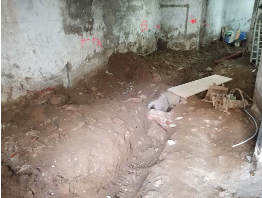
FOTOGRAFIA 9 → Panoràmica de la rasa longitudinal per la instal·lació de la canalització de les aigües residuals, des de l'àmbit-3, per l'espai d'entrada (àmbit-1), des del nord.
